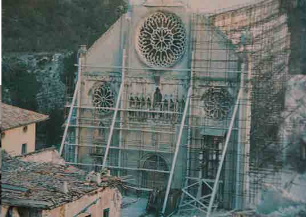
Der Dom Santa Maria Assunta von Gemona wurde schon nach dem ersten Erdstoß im Mai schwer beschädigt. Heute sind die Säulen mit Stahlkernen verstärkt. 1986 wurde der Dom wieder eingeweiht.
