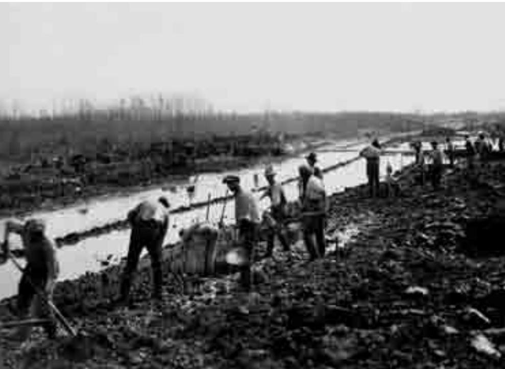
Scavo di uno dei canali 'principali' della Bonifica del Brancolo in Comune di Staranzano (1928, ora C.B. Pianura Isontina): gran parte delle opere venne eseguita a mano da maestranze locali e provenienti dal vicino Friuli e dal Veneto.
