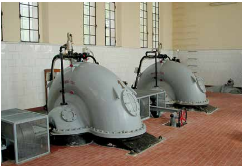
Interno di un impianto idrovoro degli anni '30, ammodernato e completamente automatizzato. Consorzio di Bonifica del Brancolo, ora confluito nel Consorzio di Bonifica Pianura Isontina.
